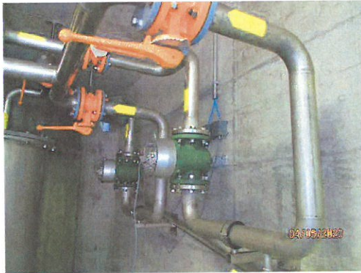
Foto 2 Bestehende Gaszähler der Faultürme 1 und 2
