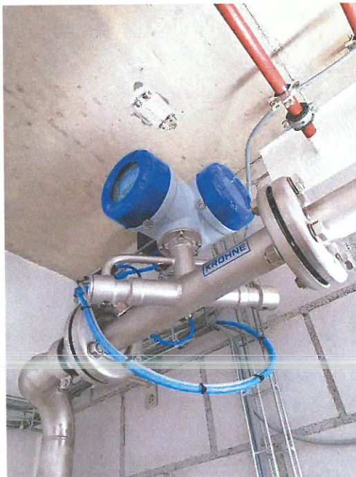
Foto 4 Beispiel einer Methan- und Gasmengenmessung
